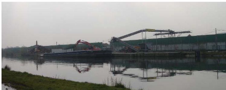
Laden en lossen op de kade van BSV-Devamix (zicht vanuit de noord-oever). De kade wordt deels ook gebruikt door Casier, een groothandel in Deerlijk.
